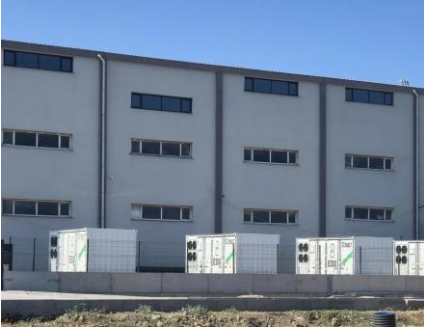
Muradiye fabrikası ve konteyner tipi ESS üniteleri
